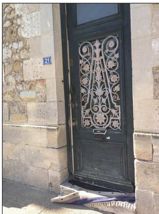
Calfeutrages de fortune pour la porte d'entrée d'un immeuble dégradé de la rue René ROQUES en centre-ville.
