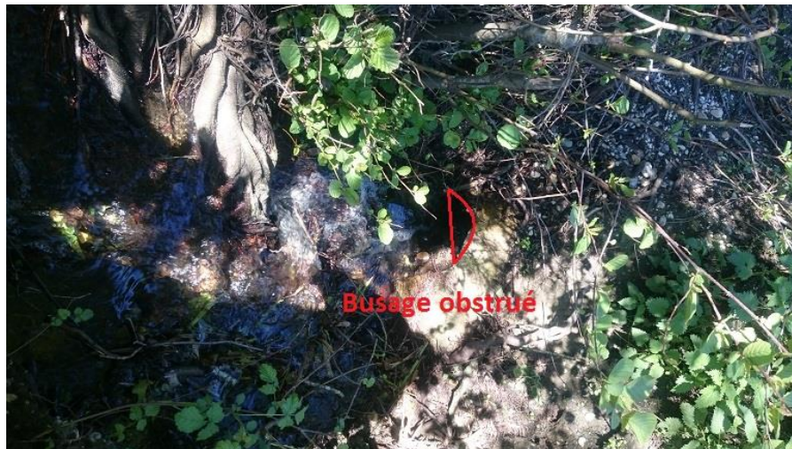
Figure 5 - Arbre entravant le ruissellement à l'intersection de la rue Feyteau et route des Brouilleaux
