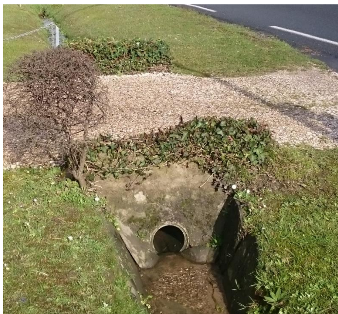
Figure 7 - Busage en entrée de propriété avenue de la Sauque
