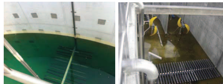
RAMPES DE DIFFUSEURS
