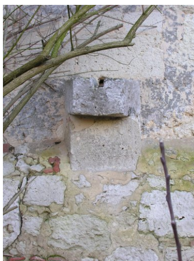
Fig. 8 - Bâtiment sud : écoulement de l'évier de l'étage.
