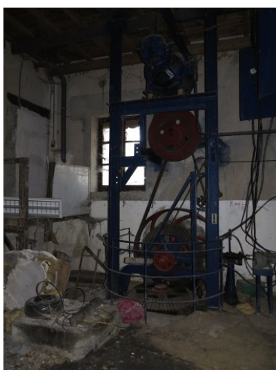
Fig. 22 - Salle des machines : la turbine.
