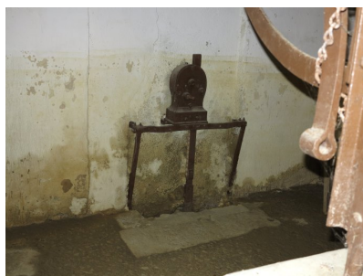
Fig. 26 - Vanne commandant l'arrivée d'eau à la roue est.
