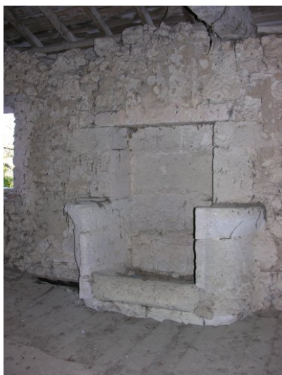
Fig. 10 - Bâtiment sud : évier de l'étage.
