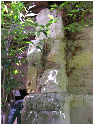
Fig. 8 - Cloître : le mur arraché de la galerie ouest.
