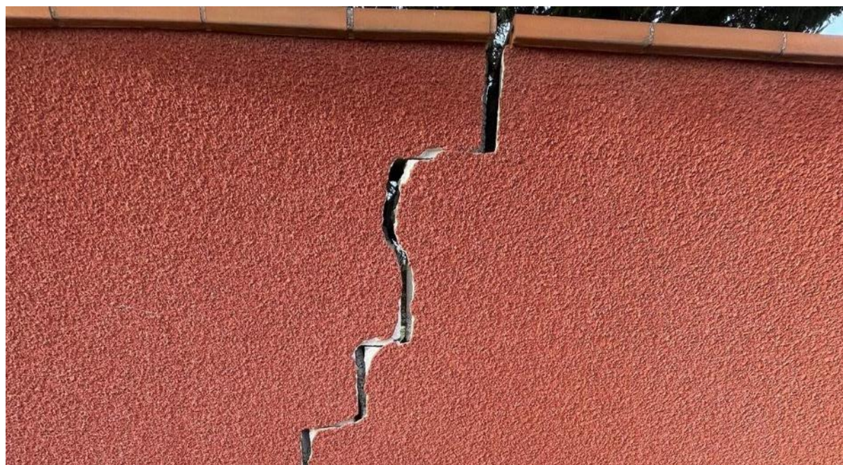
Illustration 113 : Mur fissuré en raison de mouvements de terrain induits par la rétractation et le gonflement du sol argileux (Photographie prise hors commune)
