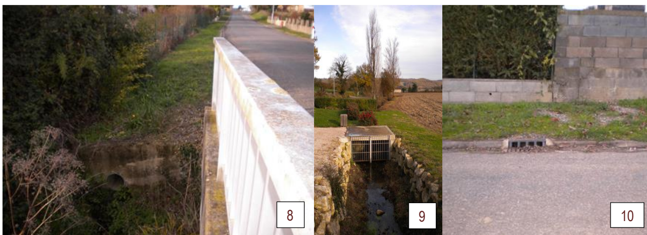
8 - Ouvrage pour la RD 261, sur le ruisseau de SAINT PE. Ici on peut constater le busage en \varnothing 300 mm le long de la RD 261, coté gauche, qui se jette dans le ruisseau. Ce busage récupère des eaux depuis le carrefour de la mairie et le long de la RD 280. 9 - RD 261 - Vue sur une grille avaloir obstruée en partie par des feuilles d'arbres. Les eaux de pluies longent le caniveau constitué par les bordures et rejoignent la canalisation de diamètre 300 mm vue sur la photo précédente.
