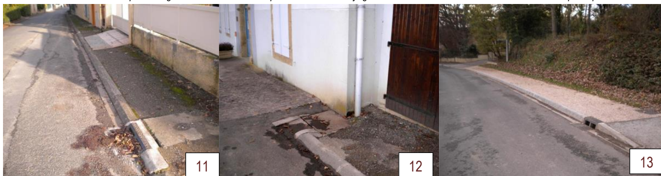
11 - RD 281 en remontant vers la mairie – Vue sur une grille obstruée par des feuilles d'arbres. Ceci indique la présence d'une canalisation sous trottoir qui rejoint la canalisation 300 mm le long de la RD 261. En-dessous grande grille sur trottoir et qui rejoint le même réseau. 12 - Exemple de raccordement de gouttière, à coté de la mairie. 13 - Exemple de regard à grille sur aménagement récent. La canalisation est située sous trottoir et se rejette plus bas dans le fossé
