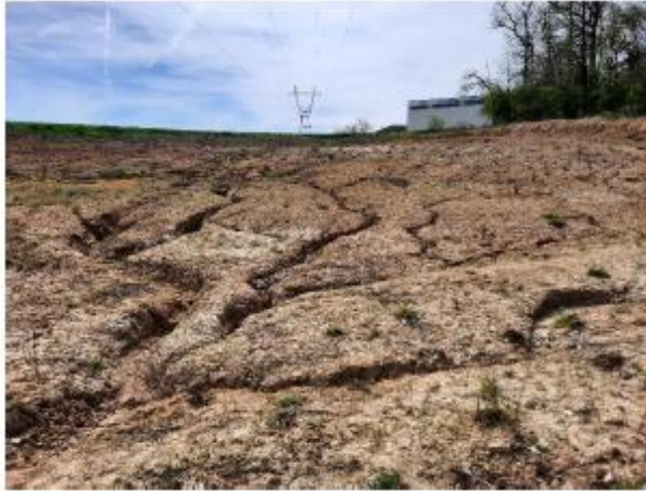
Vue des ravinements constatés Photo SOE 04-2024
