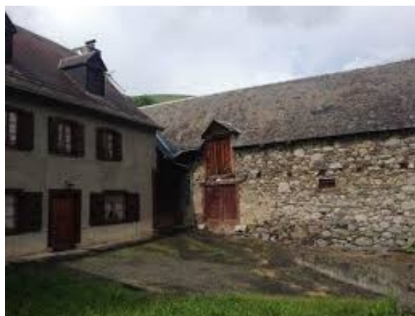
Toiture sans gouttière
