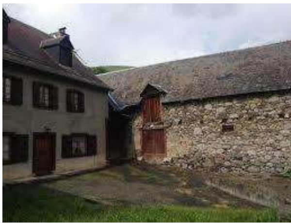
Toiture sans gouttière
