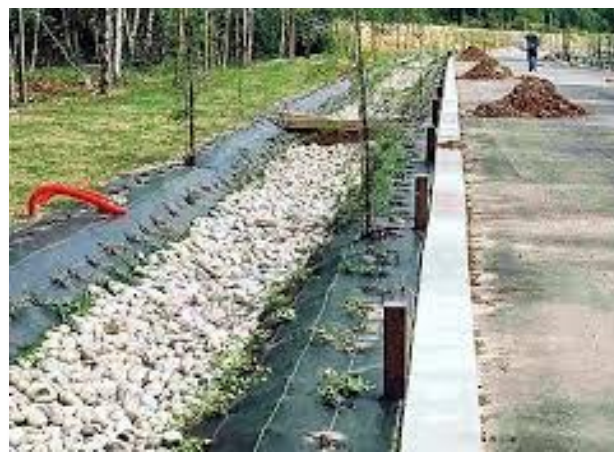
Noue plantée et filtrantes (sols imperméables)
