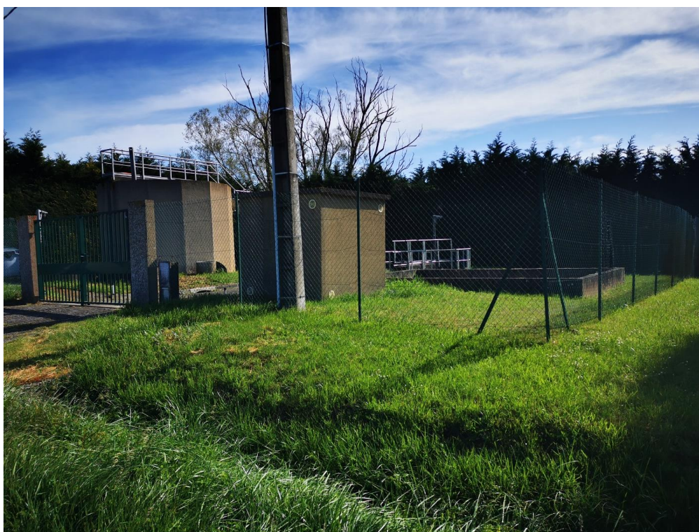
Figure 2 : Photo de la station d'épuration (STEP) de la commune de Noueilles (Source : Notice explicative du Sicoval)
