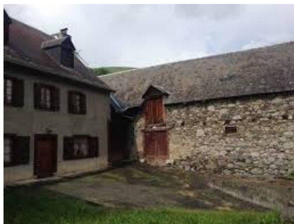
Toiture sans gouttière
