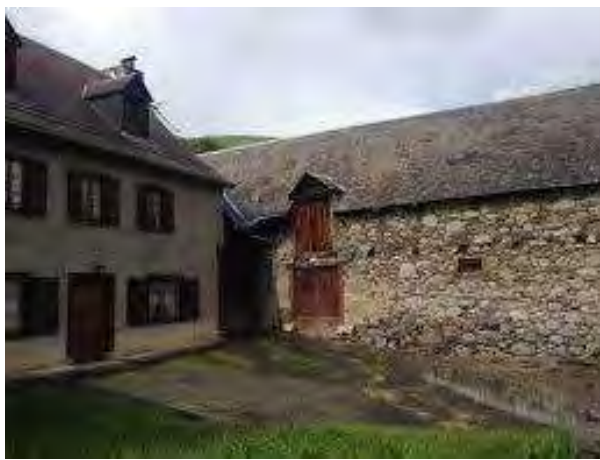
Toiture sans gouttière
