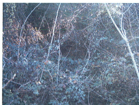
Fort enherbement en sortie d'ouvrage
