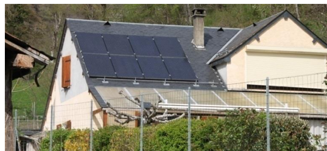
Figure 99 : Panneau Photovoltaïque sur maison d'habitation
