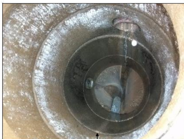
1 infiltration en haut de la cheminée du regard
