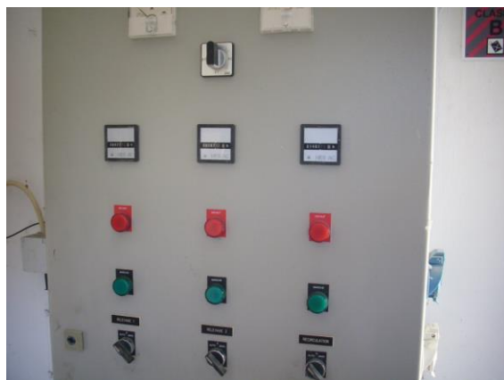
Armoire de contrôle commande 3 organes électromécaniques : 2 pompes de relèvement et 1 pompe de recirculation
