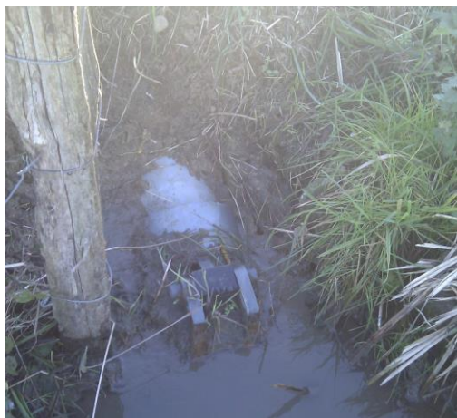
Exutoire avec clapet anti-retour
