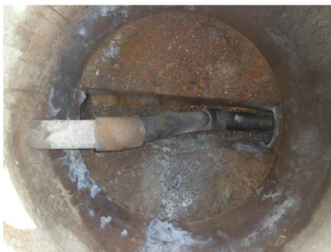
Exutoire de la canalisation de refoulement du stade : Présence de H 2 S
