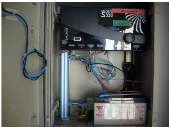
Dispositif de télésurveillance par Sofrel
