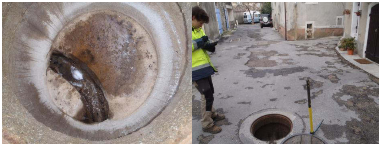
Illustration n°4 : Cunette défectueuse dans RV n°98, Chemin des Jardins à Vic-le-Fesq
