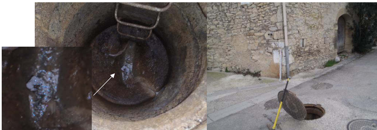
Illustration n°3 : Cunette défectueuse dans RV n°16, Grand'Rue à Vic-le-Fesq
