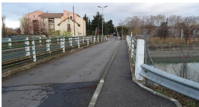
Le pont du Chemin du Moulin d'Etienne peu sécurisant pour les piétons et vélos
