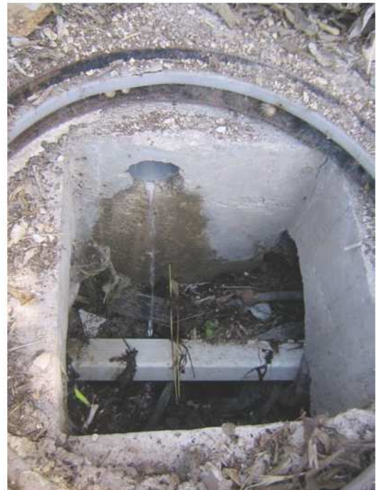
Photographie 5 : Tampon du réseau pluvial avec canalisation obturée
