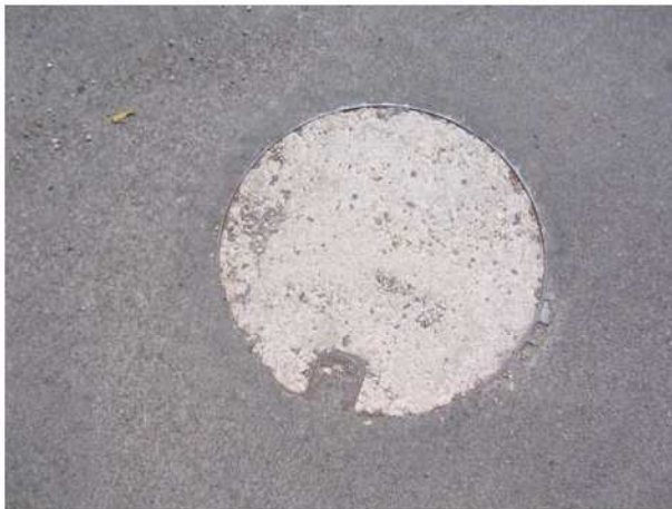
Photographie 1 : Tampon bloqué par le bitume
