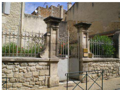
Mur bahut de moellons devant être enduits, piles de pierre de taille, portail et grille fer du jardin du 1bis rue Victor Hugo (secteur centre)
