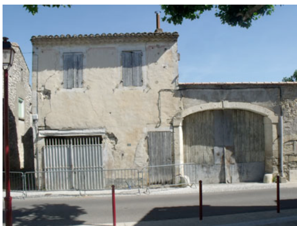
Bâti dégradé Rue de la Forge
