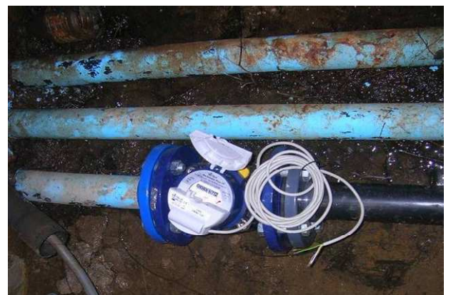
Réservoir de Besson : Compteur de distribution Village
