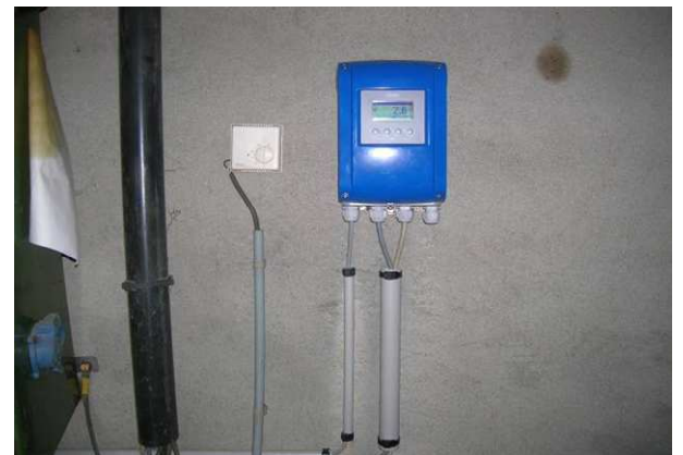
Réservoir de Rochessadoule : Débitmètre d'adduction/distribution
