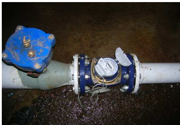
Réservoir de Rochessadoule : Compteur de distribution Village (bas service)
