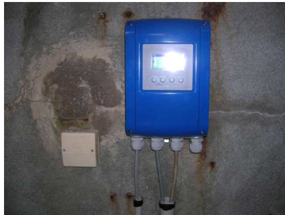
Station de Lavalette : Débitmètre
