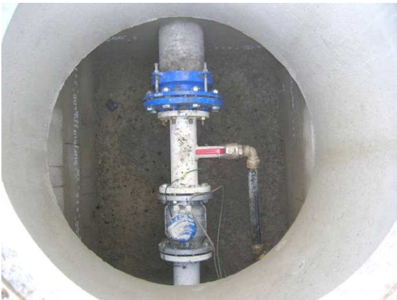
Station de Lavalette : Débitmètre
