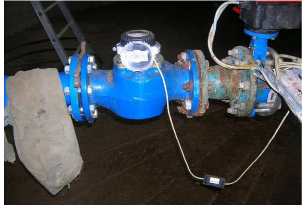
Réservoir de Rochessadoule : Compteur d'entrée du réservoir
