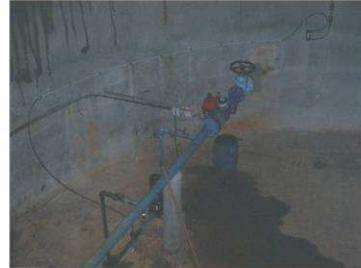
3 Arrivée de la prise d'eau
