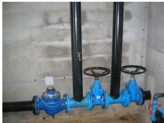
Réservoir de Chantepedrix: Compteur de distribution Robiac
