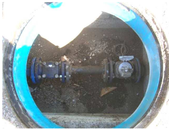
Réservoir de Savoie : Compteur de distribution Village
