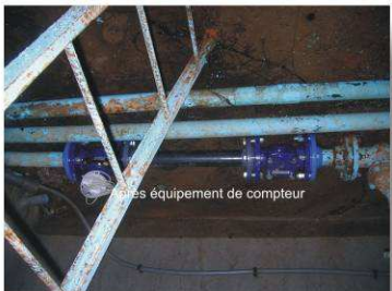
2 Vue de dessus des conduites et compteur
