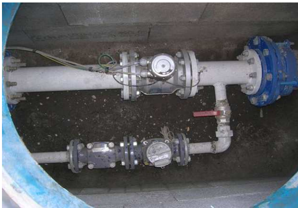
Réservoir de Rochessadoule : Débitmètre d'adduction/distribution
