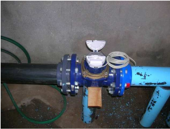
Réservoir du Sapet : Compteur de distribution Village
