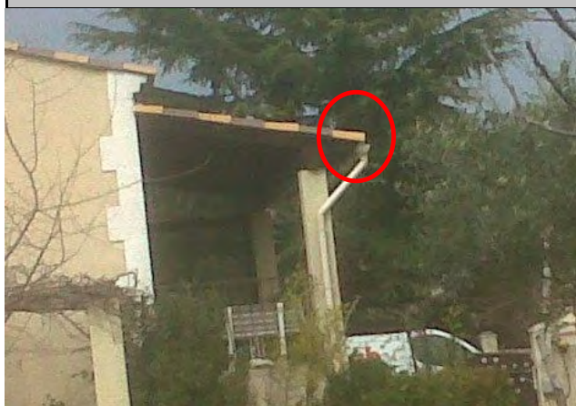
Photographie du défaut
