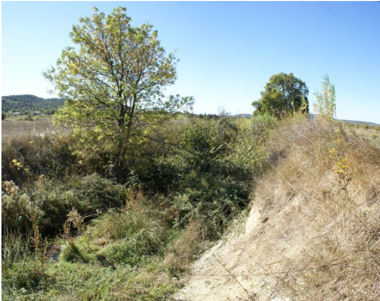
Un effondrement de berge probablement occasionné par une crue
