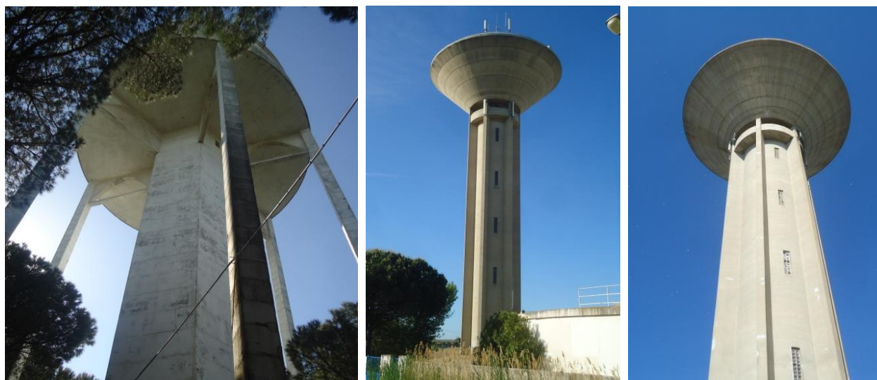
De gauche à droite, réservoirs de Malamousque, Port Camarque, et Boucanet
