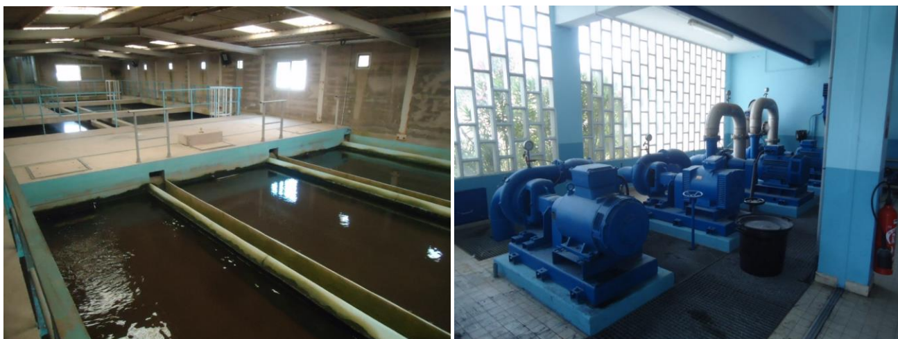
Filtres à sable, et pompes de refoulement vers réservoir de Port Camargue.
