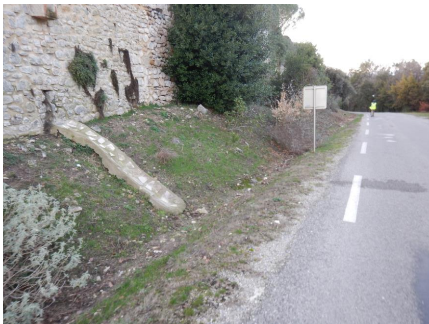
Illustration 5 : Fossé récupérant les écoulements du village de Cornillon (Route de Cornillon, source : Cereg).
