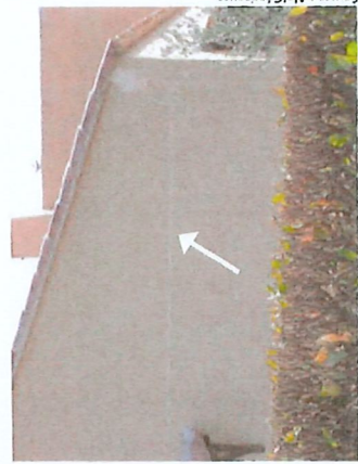
Source : Alpi Géorisques. Fissuration traduisant un décollement de la structure par absence de liaisonnement entre niveau bas et combles.
