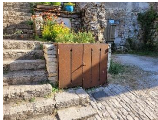
Exemples – compteur électrique
