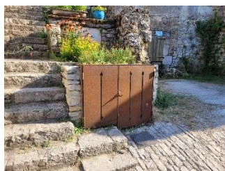
Exemples – compteur électrique
