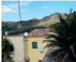
Fenêtre de toit rapportée inadaptée au site
