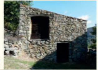
Grande porte de remise à l'étage pour faciliter le stockage et la manutention
