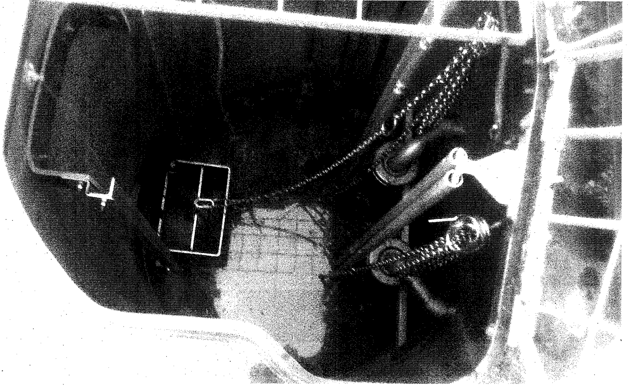
Photo 1 : Poste de relevage de Ghjereta, avec matériel de prélèvement installé.
