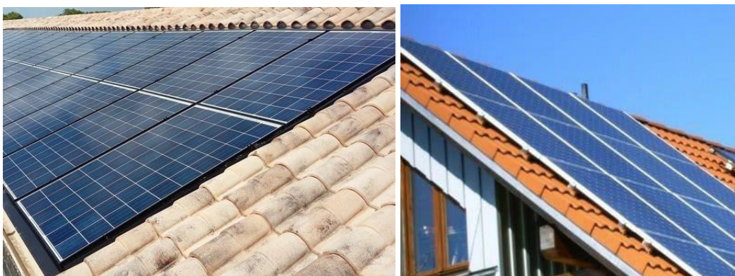
Exemple de panneaux solaires intégrés dans la pente de la toiture
