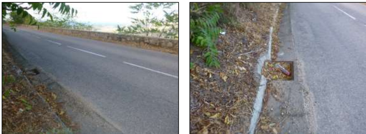
Photo 3 : Localisation du regard sans grille et bouché après la sortie du village direction LUMIO (25/09/2019)
