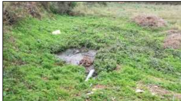
Photo 2 : Dispositif d'ANC défaillant
