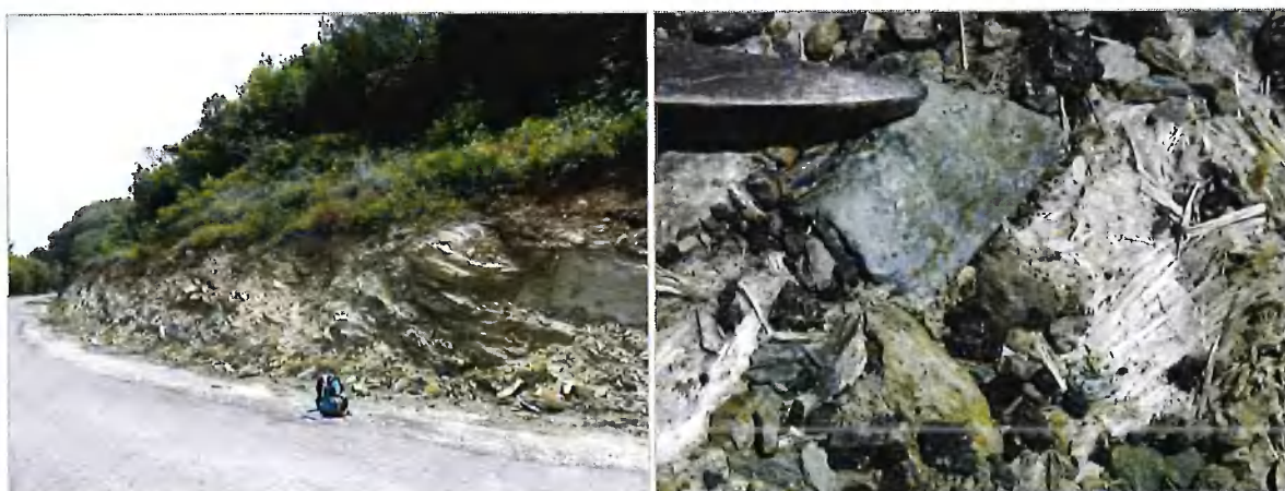
Illustration 29 : Affleurements de serpentinites recoupés par la D13, mis à nu à l'occasion de travaux d'élargissement (secteur d'Anneto) (Site 2BFC298).
