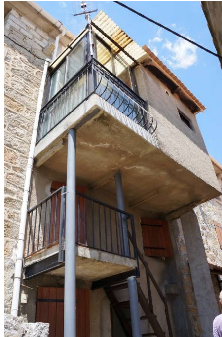
Ajout inadapté sur façade traditionnelle
