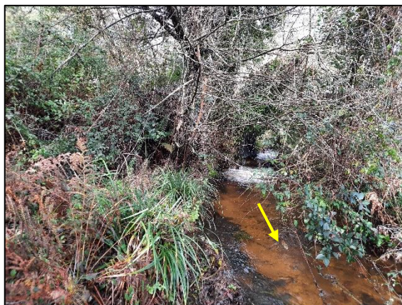
Photo 34 : Ouvrage de traversée du ruisseau de TINTURAGGIO (DN1500, EXU 25)
