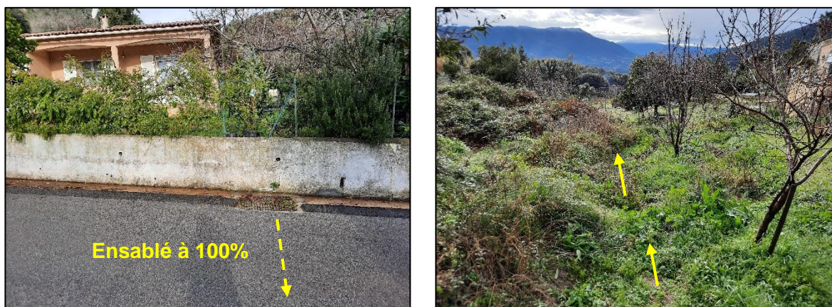
Photo 23 : BV n°12, grille ensablée et exutoire (EXU 12) non fonctionnel
