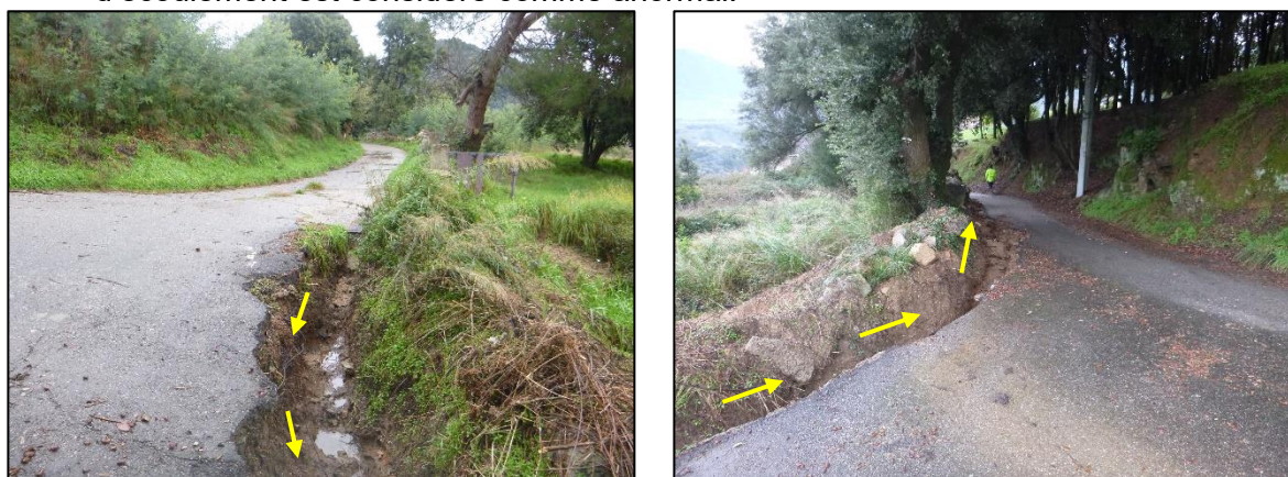
Photo 14 : BV n°9, chemin de grille et ravinelements en bord de voirie
