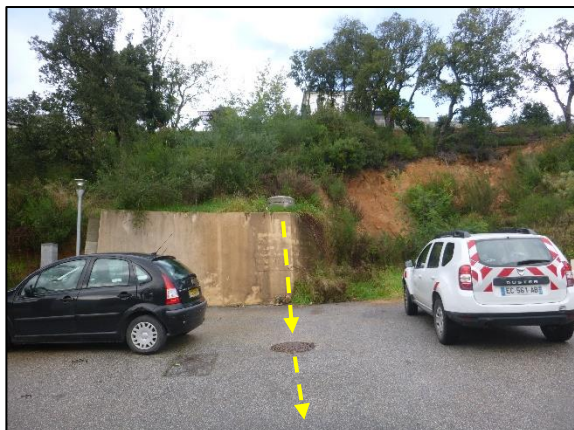
Photo 31 : BV n°20, jonction du réseau pluvial entre la partie haute et la partie basse
