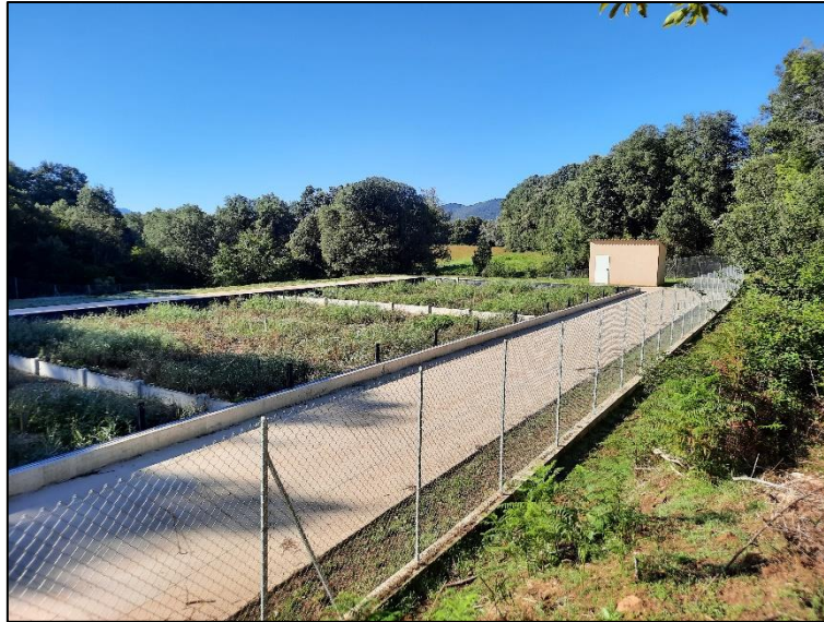
Figure 9: STEP Filtre planté de roseaux au lieu-dit CANASO
