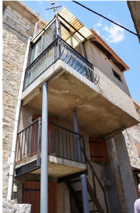
Ajout inadapté sur façade traditionnelle
