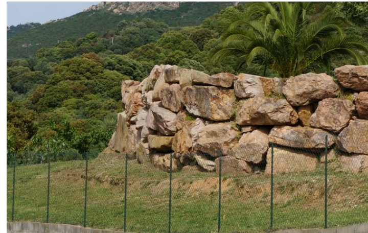
Enrochement démesuré qui ne se justifie pas au regard de la pente du site, aucun soin esthétique.
