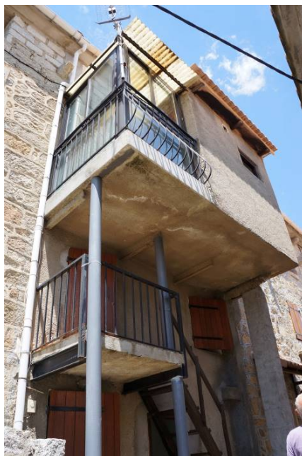
Ajout inadapté sur façade traditionnelle
