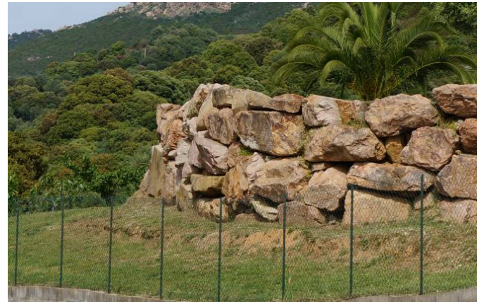
Enrochement démesuré qui ne se justifie pas au regard de la pente du site, aucun soin esthétique.
