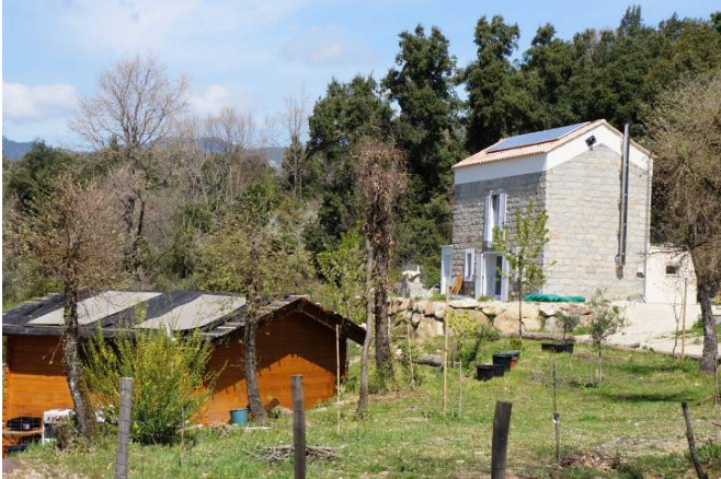
Surélévation d'un bâtiment traditionnel avec des matériaux différents ; annexes en bois clair brillant, enrochement, panneaux solaires trop visibles ; menuiseries PVC.
