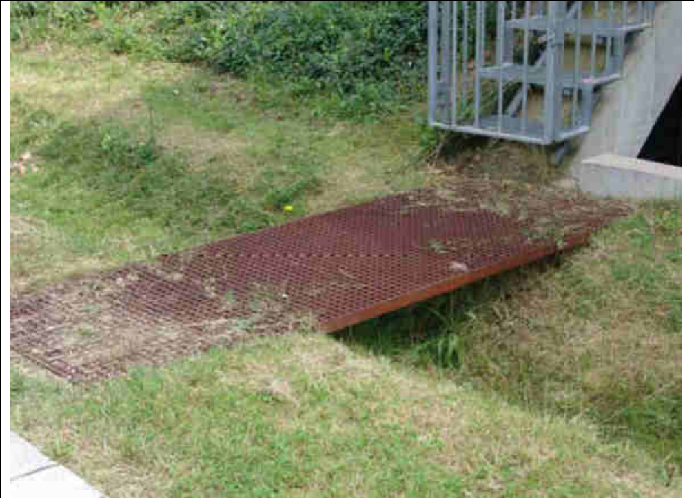
Enjambement d'un petit fossé longeant un trottoir au pied d'une sortie de secours d'en bâtiment public
