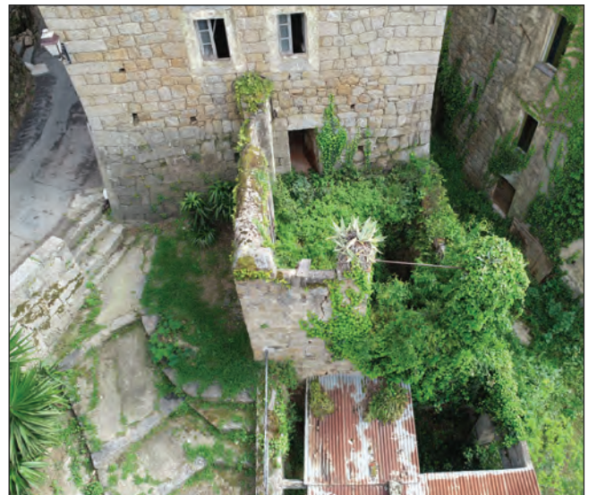
Développement végétatif et bâtiment accolé en ruine
