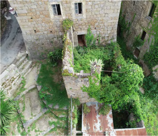
Développement végétatif et bâtiment accolé en ruine
