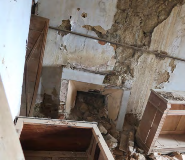
Cheminée et enduit en ruine
