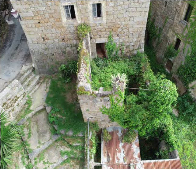
Développement végétatif et bâtiment accolé en ruine
