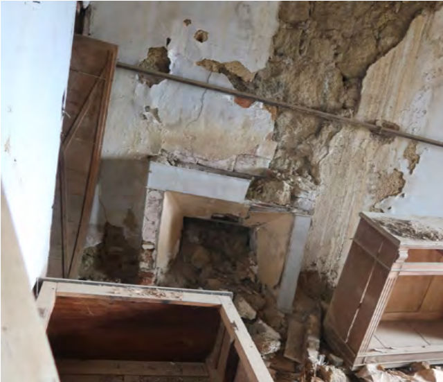
Cheminée et enduit en ruine
