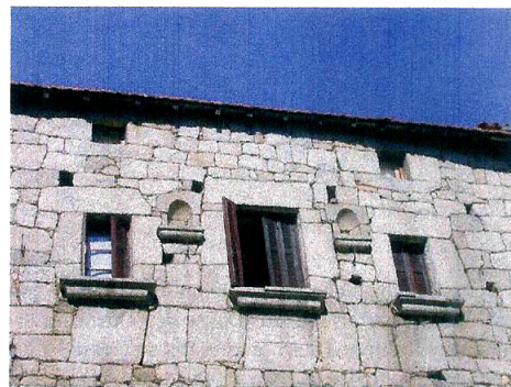
Forciolo – Détail des fenêtres de l'étage noble. Les appuis monolithes sont sculptés. Les pierres des allèges posées de champ présentent des faces approximativement carrées.
