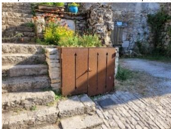
Exemples – compteur électrique
