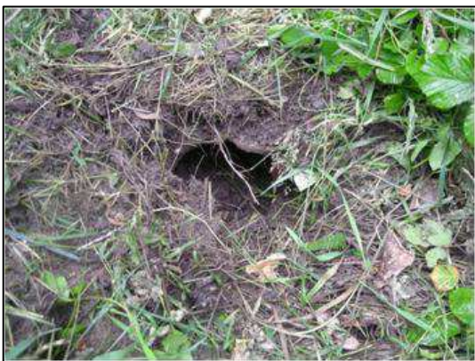
Photo 4 : Fossé rue de Pouldreuzic colmaté
