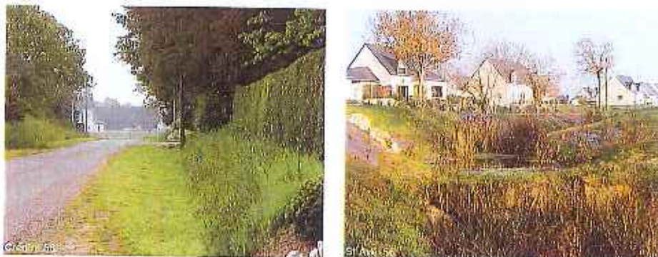
Les noues ou fossés permettent de collecter, stocker et assurer la restitution progressive de l'eau dans le milieu naturel par un système de petites retenues situées sur leur parcours.
