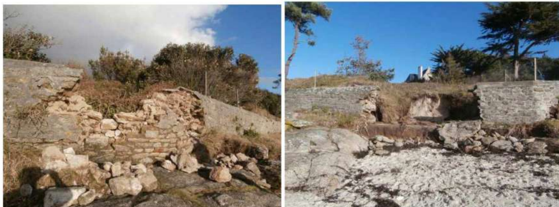
Murs privés endommagés au niveau de la plage du Large ( commune de Concarneau) – (photos réalisées par la commune lors de l'hiver 2014
