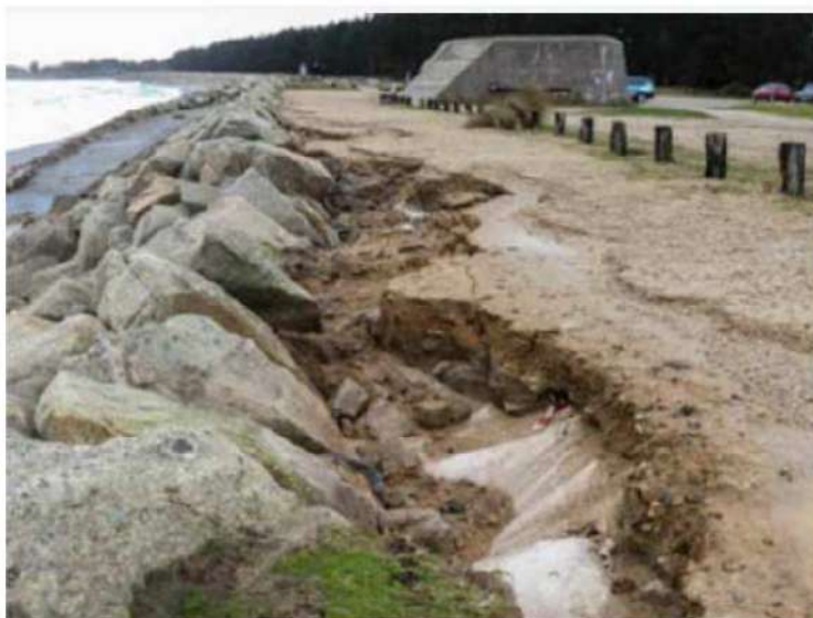
Anomalie constatée sur la crête des enrochements de la plage de Cleut Rouz (photo site internet association pour la sauvgarde du Pays Fouesnantais)
