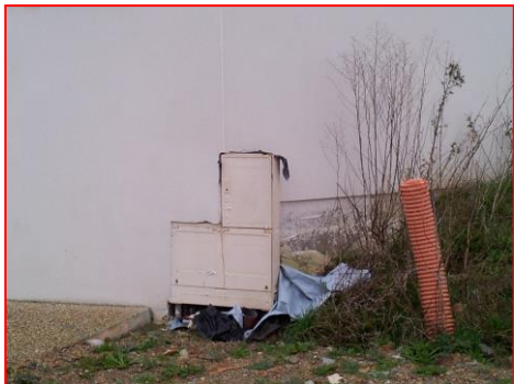
Coffret en saillie du mur
