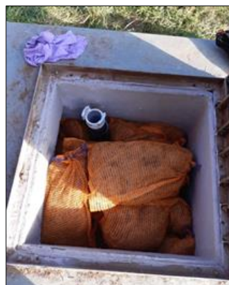
Cuve de stockage avec filtres coco remplacés
