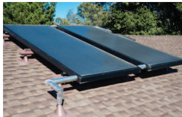
capteur thermique en toiture
