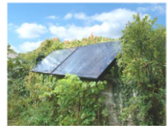
Les capteurs thermiques sont adossés à un mur du jardin. Cette solution demande une surveillance de la croissance de la végétation pour éviter toute ombre portée. Vigny (Val d'Oise) © PNR du Vexin français
