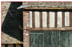
Colombages protégés par un lait de chaux.
